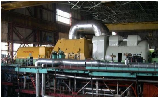
Улан-Удэнская ТЭЦ-1, ТГ №7 – 100 МВт
